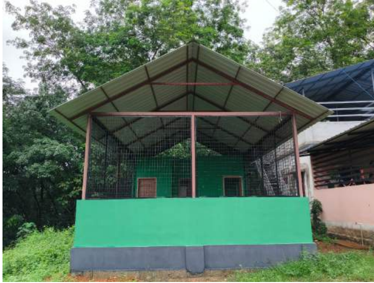
അങ്കണവാടി കോമ്പൗണ്ടിൽ നിർമ്മിച്ചിട്ടുള്ള MCF കെട്ടിടം ഉപേക്ഷിക്കപ്പെട്ട നിലയിൽ
